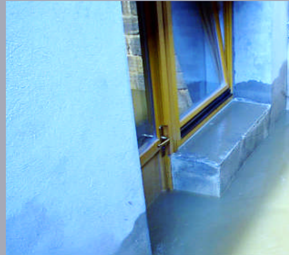
Eindringen von Wasser durch Türen (Cassel)
